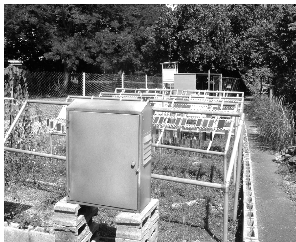
Figura 1. Armario colocado en la estación CNIC.
